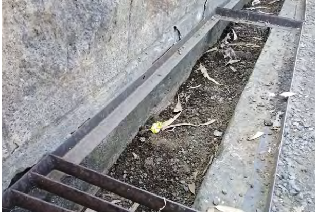
Accumulation de sédiments ou de débris dans les structures de drainage.
