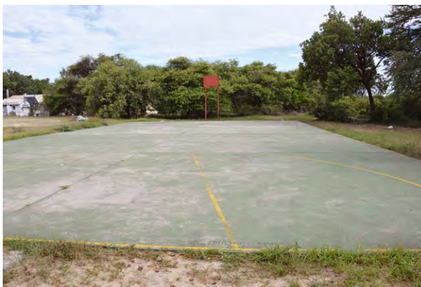
Marquage défraîchi d'un terrain de basketball.
