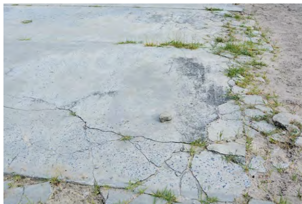
b) Surface fissurée et usée par le temps, manque d'entretien et de nettoyage réguliers.
